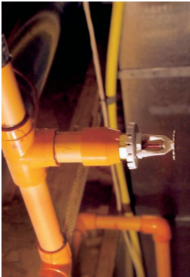
Impianto a pioggia (sprinkler)
